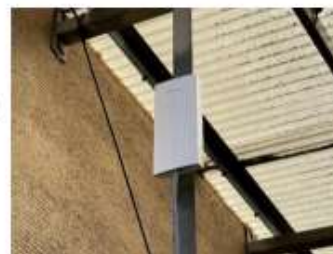
母屋軒下等の柱に設置
