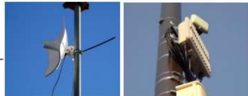
固定例：中継器は向きが変わらない様に、しっかり固定 ステンレスバンドだと錆びに強い
